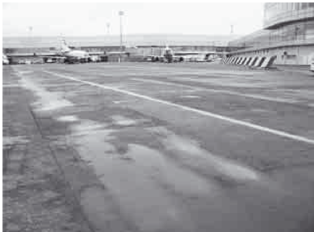
Obr. 8 : Deformace krytu vozovky na stojánce letadel, živičná vrstva tl. 60 mm na betonové desce tl. 300 mm foto: autor
