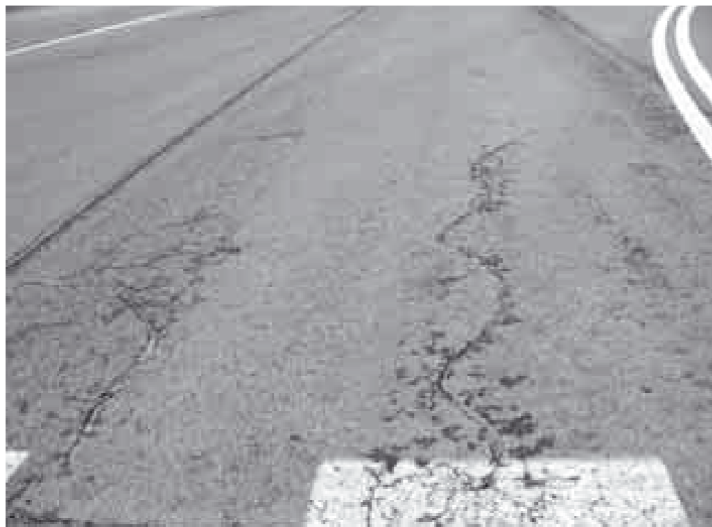
Obr. 3 : Podélné trhliny v živičných vrstvách tl. 160 mm foto: autor
