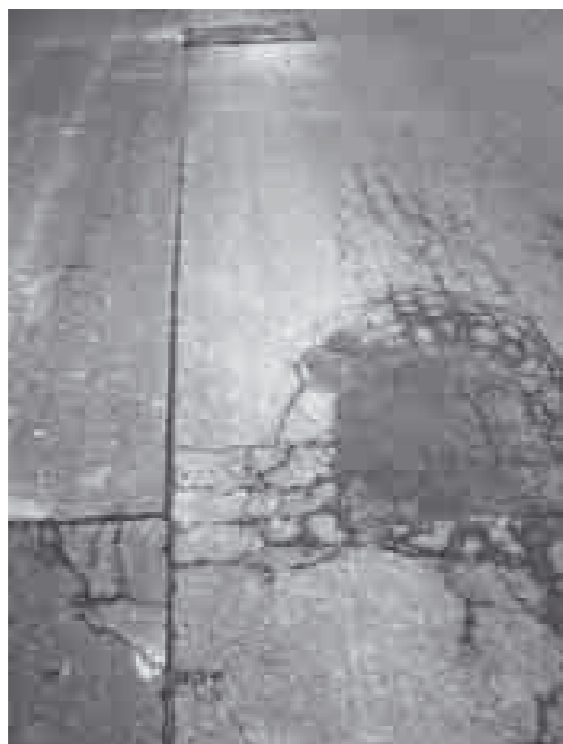
Obr. 4 : TWY F – výron vody z podkladu (stav v 04/2008) foto: autor
