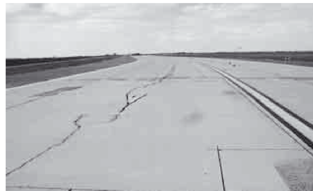
Obr. 1 : Pojezdová dráha – dvoudesková konstrukce, podélné trhliny v místě pojezdu podvozků letadel foto: autor
