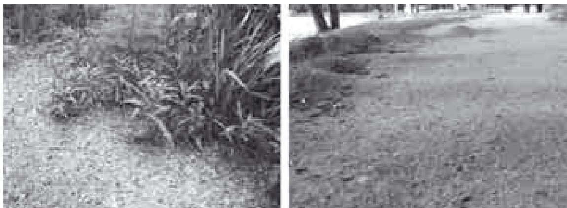
Prorůstání zeleně a kořeny stromů pod asfaltem
