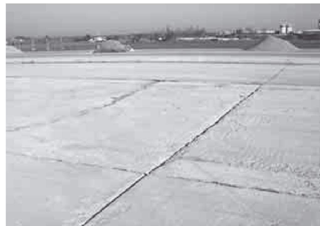
Obr. 2 : Povrch původní desky z roku 1962 (stav v roce 2004 po vybourání horní rekonstrukční desky) foto: ing. Škarková
